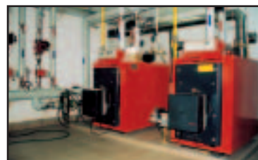
Wyposażenie jednej z nowych kotłowni gazowych w placówkach oświatowych.
